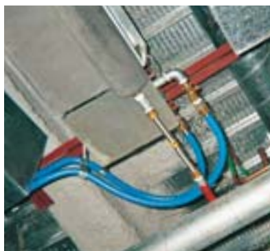
ファンコイルユニットへの配管例
