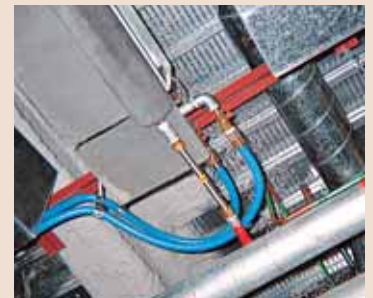
ファンコイルユニットへの配管例
